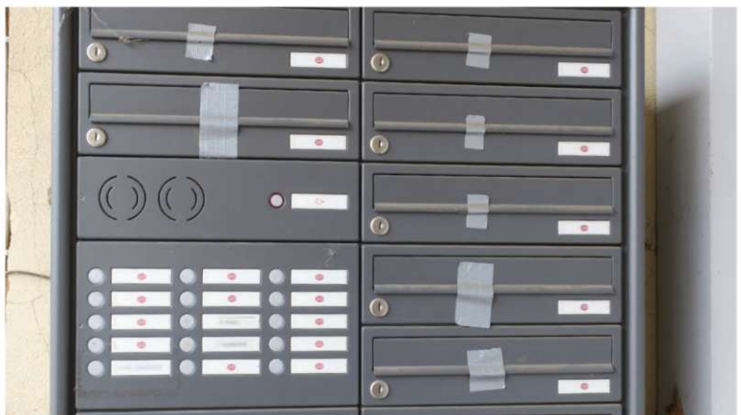
Abb. 4.15 Briefkasten und Klingelschilder mit leer stehende Wohnungen
