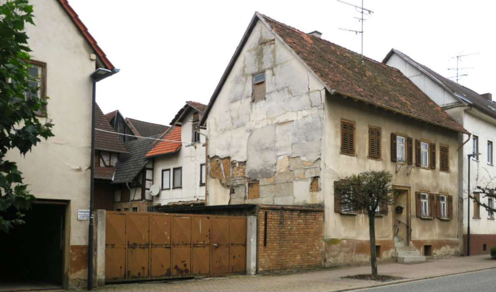
Abb. 3.5 sanierungsbedürftiges Haus an der Hauptstraße
