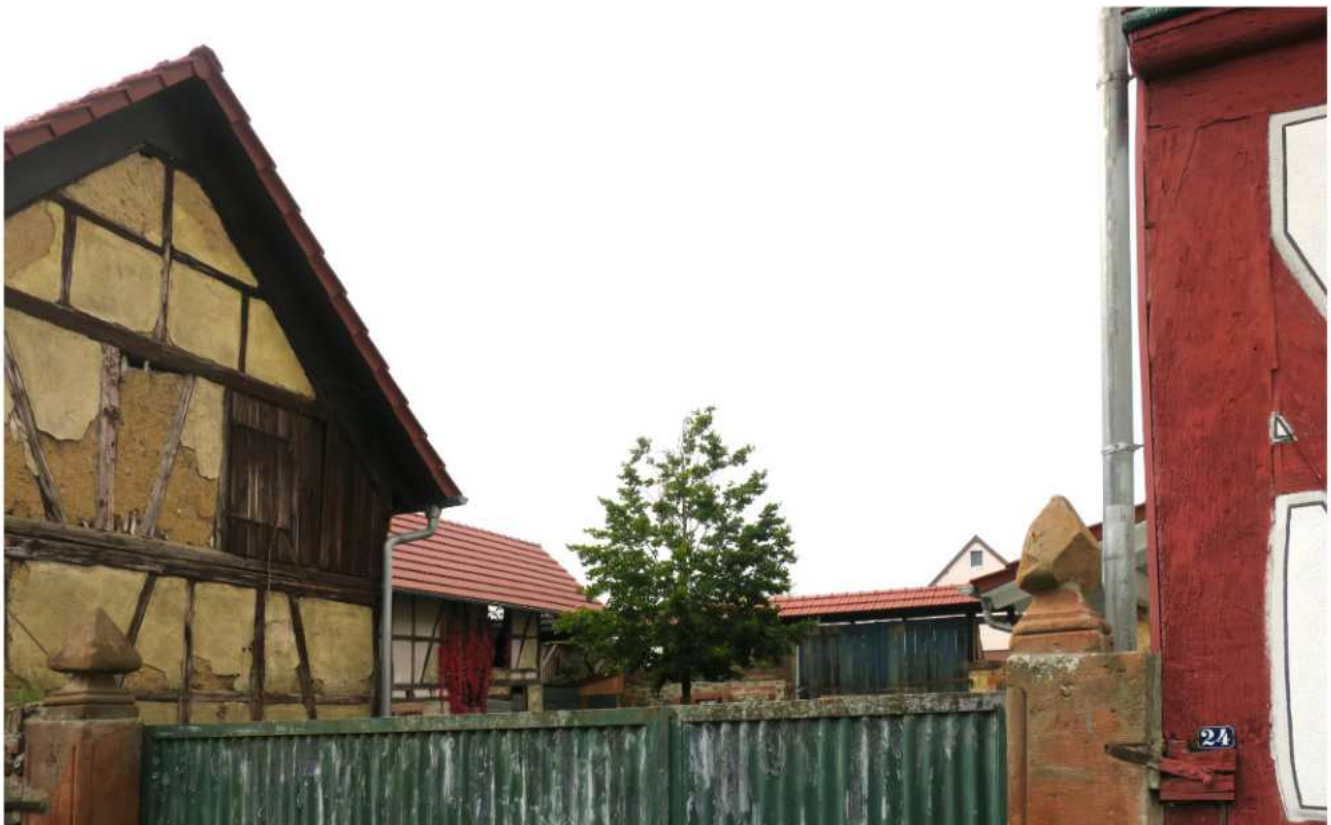
Abb. 4.21 Beispiel-Scheune mit dringendem Sanierungsbedarf
