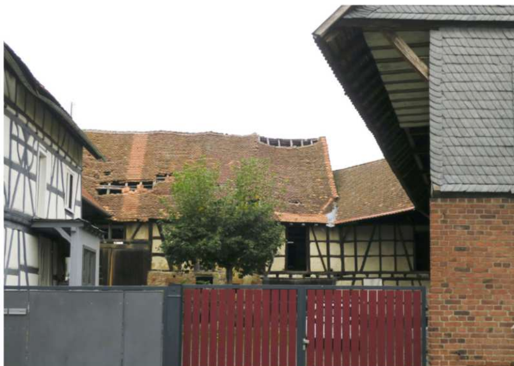
Abb. 4.19 Beispiel-Scheune mit dringendem Sanierungsbedarf
